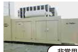
非常用 ディーゼル 発電設備
