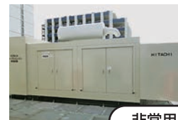
非常用 ディーゼル 発電設備
