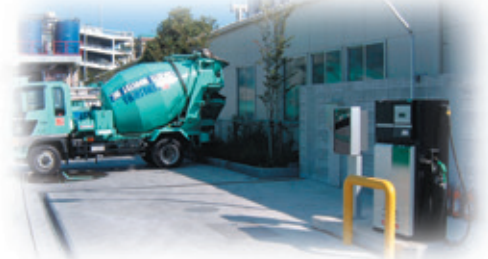
自家用給油設備
