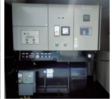
発電機操作盤
