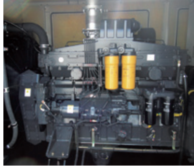
発電機 (小松製作所製)
