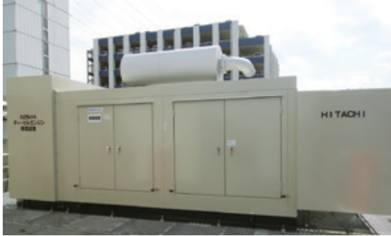
日立製作所製非常用発電機 (サンパワー)
