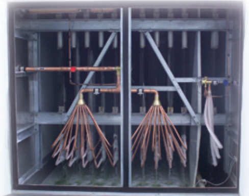
チラー内部配管
