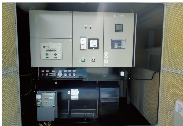
発電機操作盤
