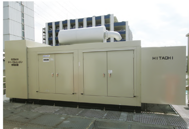
日立製作所製非常用発電機 (サンパワー)
