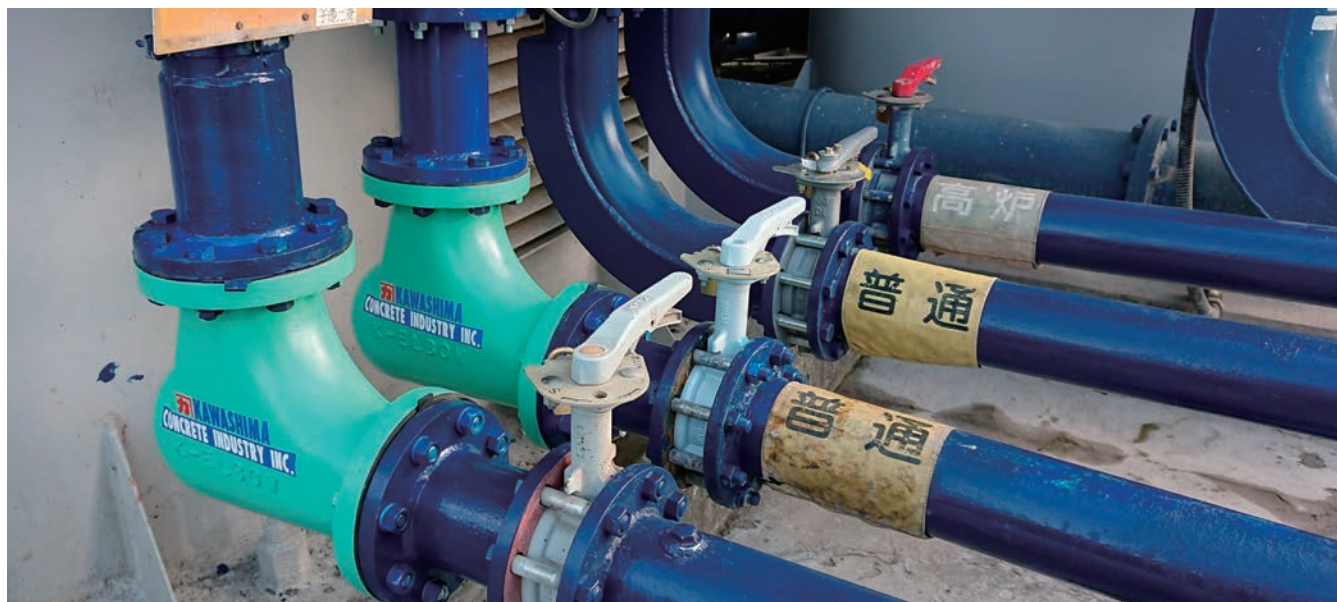
写真-2 鋳物で制作したベント管（左2本）と通常のベント管（右2本）。接合部やコーナー部の内外を補強している
